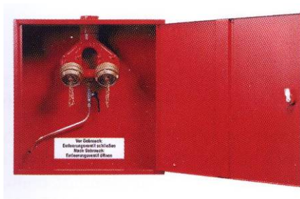
Slika 5: Mesto za dovod vode
